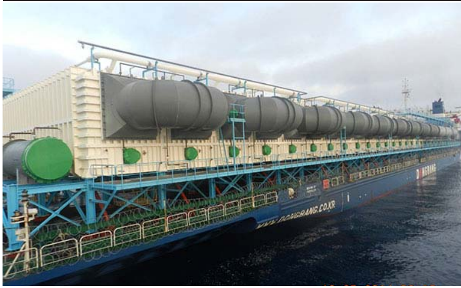
کھارے پانی کو پینے کے قابل بنانے کا پلانٹ (Desalination Plant)
